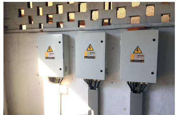
/ Instalación antes del Revamping
